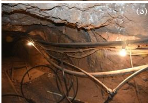
شکل ۱۰ الف، ب، ج، د- لوله‌های هوادهی در تونل‌های معدن فیروزه و مجاورت آنها با سیم‌های برق و دیگر لوله‌ها
