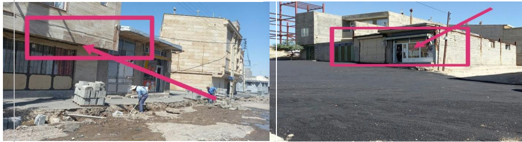
تخلف پیشروی در معبر(خارج از ضوابط ساخت و ساز)
