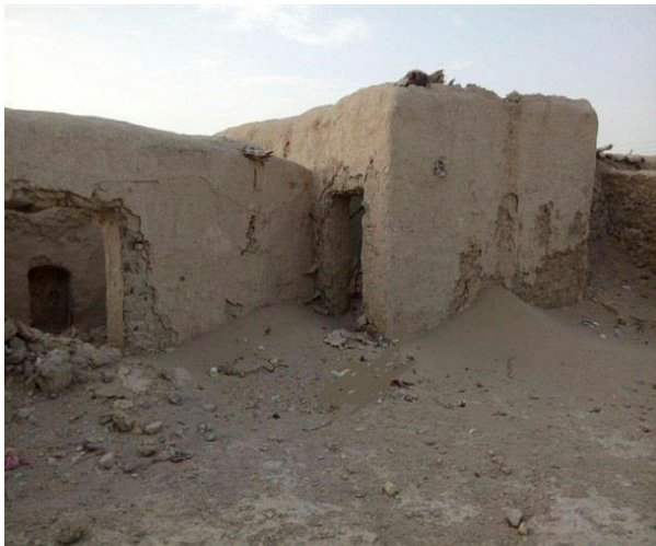
شکل ۹- تخریب قسمت ورودی توسط ضربات ماسه‌ها
