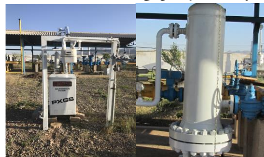
شکل ۳- نمای گرم کن جدید نصب شده در ایستگاه تقلیل فشار
