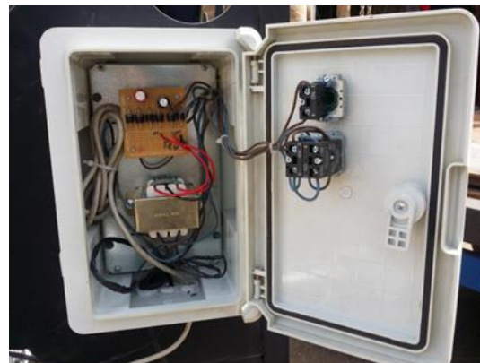
شکل ۴- تابوی برق دستگاه
